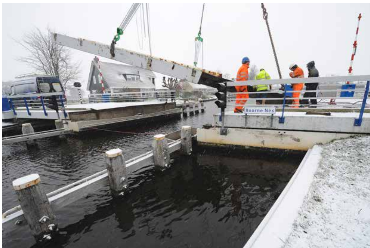
De monteurs van Machinefabriek Rusthoven in Groningen moesten eind januari de snerpende kou trotseren bij het verwijderen van het brugdek van de Boarnebrug in Nes. (Foto: Noordoost.nl/Alex J. de Haan)
